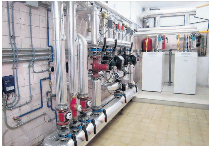
Sala de calderas de un edificio de viviendas.
